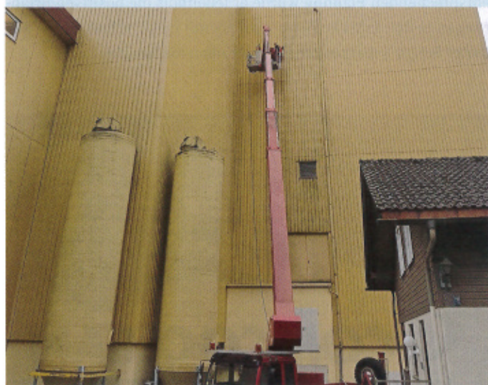
Die Fassade der Weissachmühle hat eine maximale Höhe von 38 Metern und ist 4.000 Quadratmeter groß. Bilder: TG HyLift
