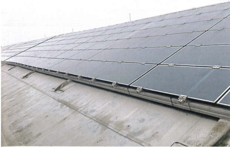
Die große Dachfläche teilt sich in mehrere 100 m lange Tische (oder Reihen) mit verschiedenen Neigungsgraden – kein leichtes Terrain, um die PV-Anlage vom Ruß zu befreien
